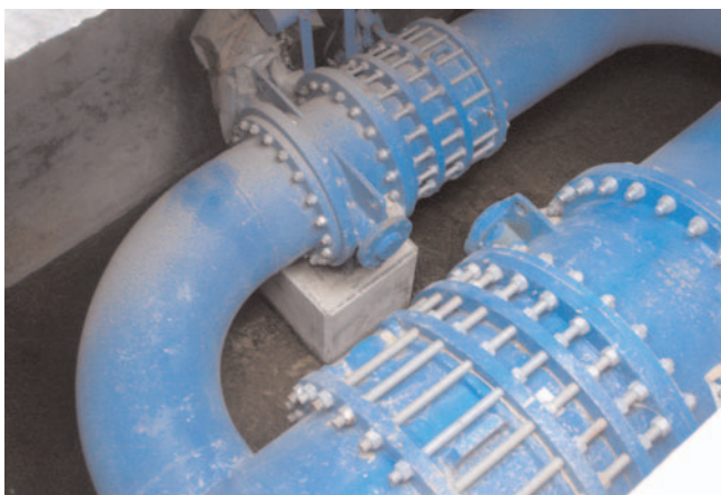
Fig. 6. Tuberías de entrada y salida/Inlet and outlet pipes to the surge tanks.
