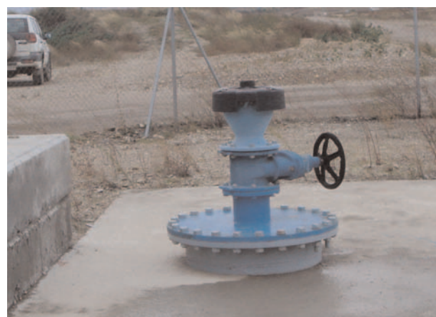
Fig. 7. Ventosa de la línea derecha junto al calderín/Vent on the right-hand line next to the surge tank
